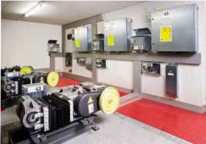
DR SGB 142 als 3er-Gruppe in einem Geschäftshaus in Verbindung mit einer CO MX-Steuerung
